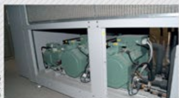
La centrale frigorifique produit du froid positif pour la climatisation et du froid négatif pour alimenter la chambre froide.
